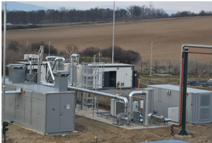
Plynová úpravňa EnviThan s kapacitou 417 Nm 3 /h predstavuje druhý biometánový projekt spoločnosti EnviTec Biogas na Slovensku. (Foto: EnviTec Biogas AG)
