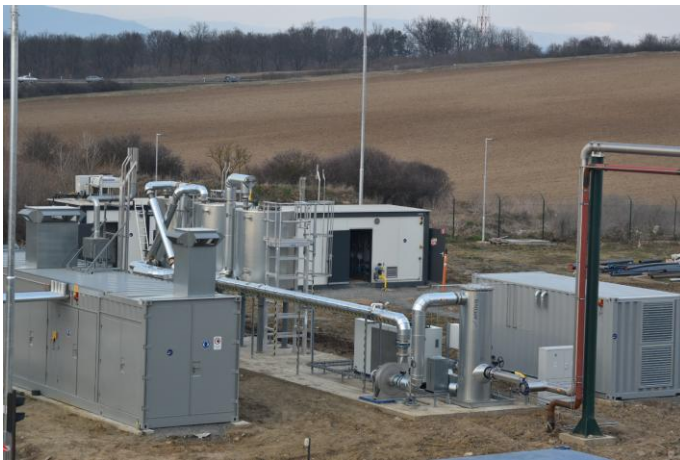
Zařízení na úpravu bioplynu EnviThan s kapacitou 417 Nm 3 /h představuje druhý biometanový projekt společnosti EnviTec Biogas na Slovensku. (Foto: EnviTec Biogas AG)
