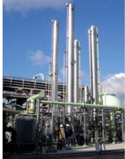
Ein spezielles Verfahren bereitet das Biogas zu Biomethan auf.
