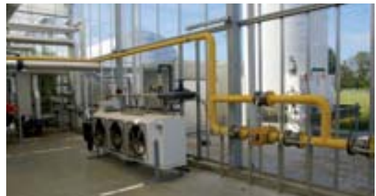
Die Heizungsanlage sorgt für ein gleichbleibendes Klima im Gewächshaus.
